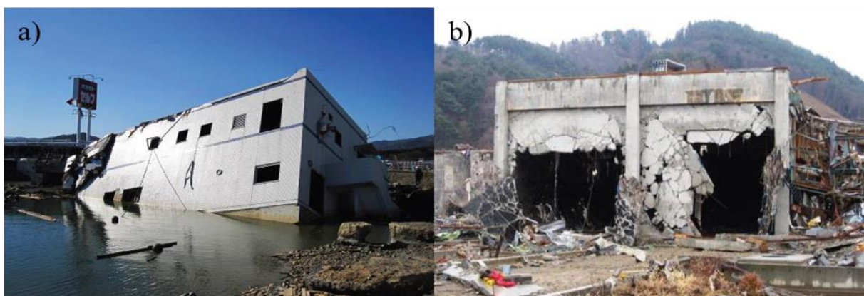
Abb. 5.15: Versagensursachen und Schadensbilder (Fukuyama, et al., 2011): a) Rutschen und b) Abbruchstellen an Wänden und Öffnungen
