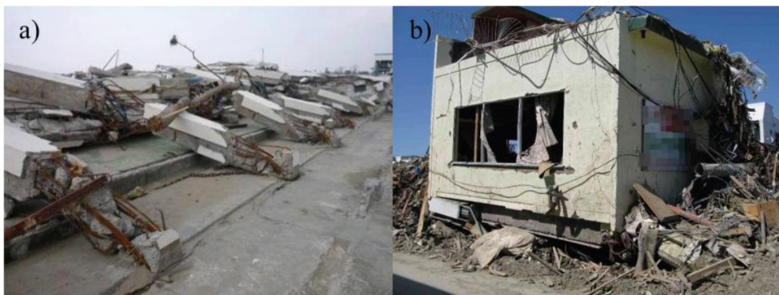
Abb. 5.13: Versagensursachen und Schadensbilder (Fukuyama, et al., 2011): a) pfannkuchenartiger Einsturz und b) Zusammenbruch der 1.Etage
