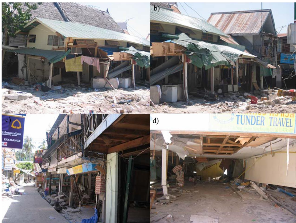
Abb. 5.5: Zerstörung von Holzgebäuden auf Phi Phi Island, Thailand (Saatcioglu, et al., 2005): a), b), c) und d) verschiedene Ansichten von Küstenkonstruktionen
