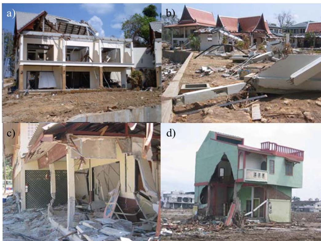
Abb. 5.11: Zerstörung von Stahlbetonbauten: a) Khao Lak, Thailand (Rosetto, et al., 2006), b) Khao Lak, Thailand (Saatcioglu, et al., 2005), c) Phi Phi Island, Thailand (Saatcioglu, et al., 2005), d) Banda Aceh, Indonesien (Saatcioglu, et al., 2005)
